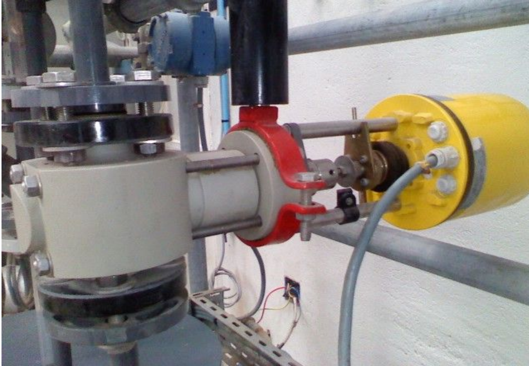
Figure 2.7 : Photo vanne automatique de régulation krammer
