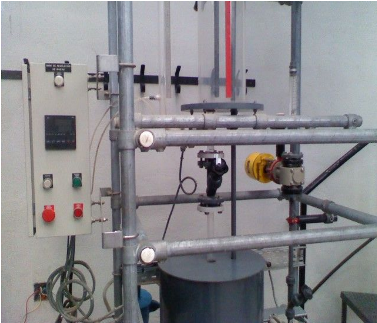
Figure 2.2 : Photo de l'installation réelle de régulation de niveau.
