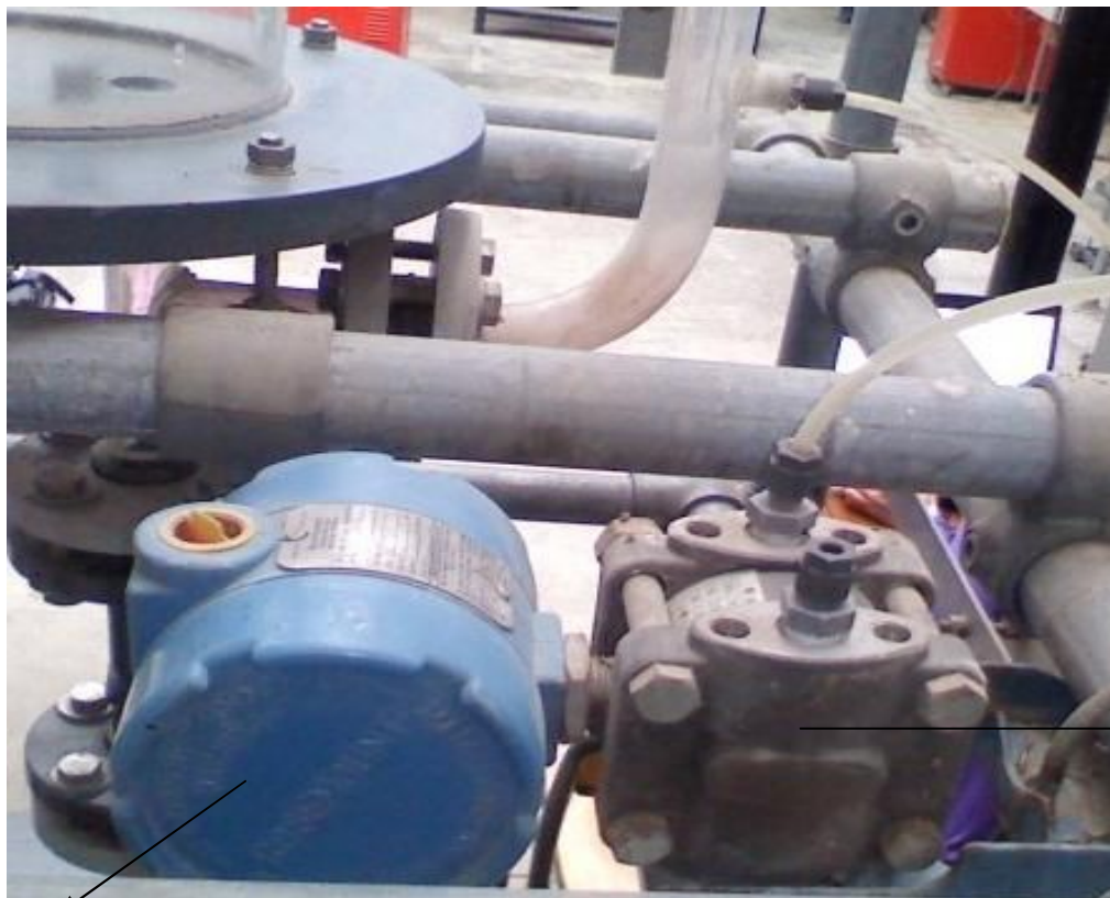
Figure 2.4 : photo du capteur-transmetteur de niveau
