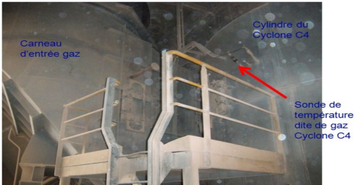
Figure 3.20 :L'emplacement actuel du Cylindre et gaine gaz sortie cyclone 4
